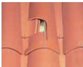
Fixation des tuiles de couvert en plain carré par crochets «S» à raison, sur 10 crochets : 8 crochets «S»
