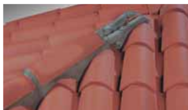
Après coupe des tuiles d'approche, mise en œuvre des tuiles Canal Restauration. Utilisation de mortier (D.T.U. 40.22 art. 2.4).
