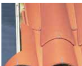
Fixation des tuiles du 1 er rang d'égout en rives latérales gauche et droite, par crochets longs à œil. Réf. CRCAN.550
