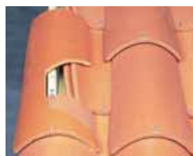
Fixation des tuiles en rives latérales gauche et droite par crochets «S» à raison de : 1 crochet «S» sur 2 tuiles.
