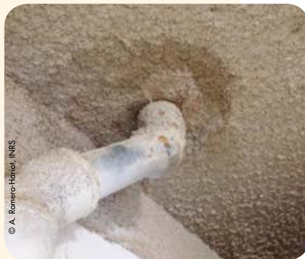
Canalisation en amiante ciment fuyarde
