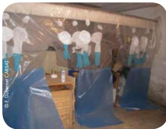
Sac à manches sur une canalisation
