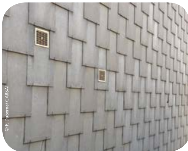
Bardage décoratif en amiante-ciment
