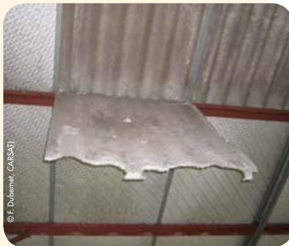
Élément de faux-plafond en carton amianté type « Panocell® »
